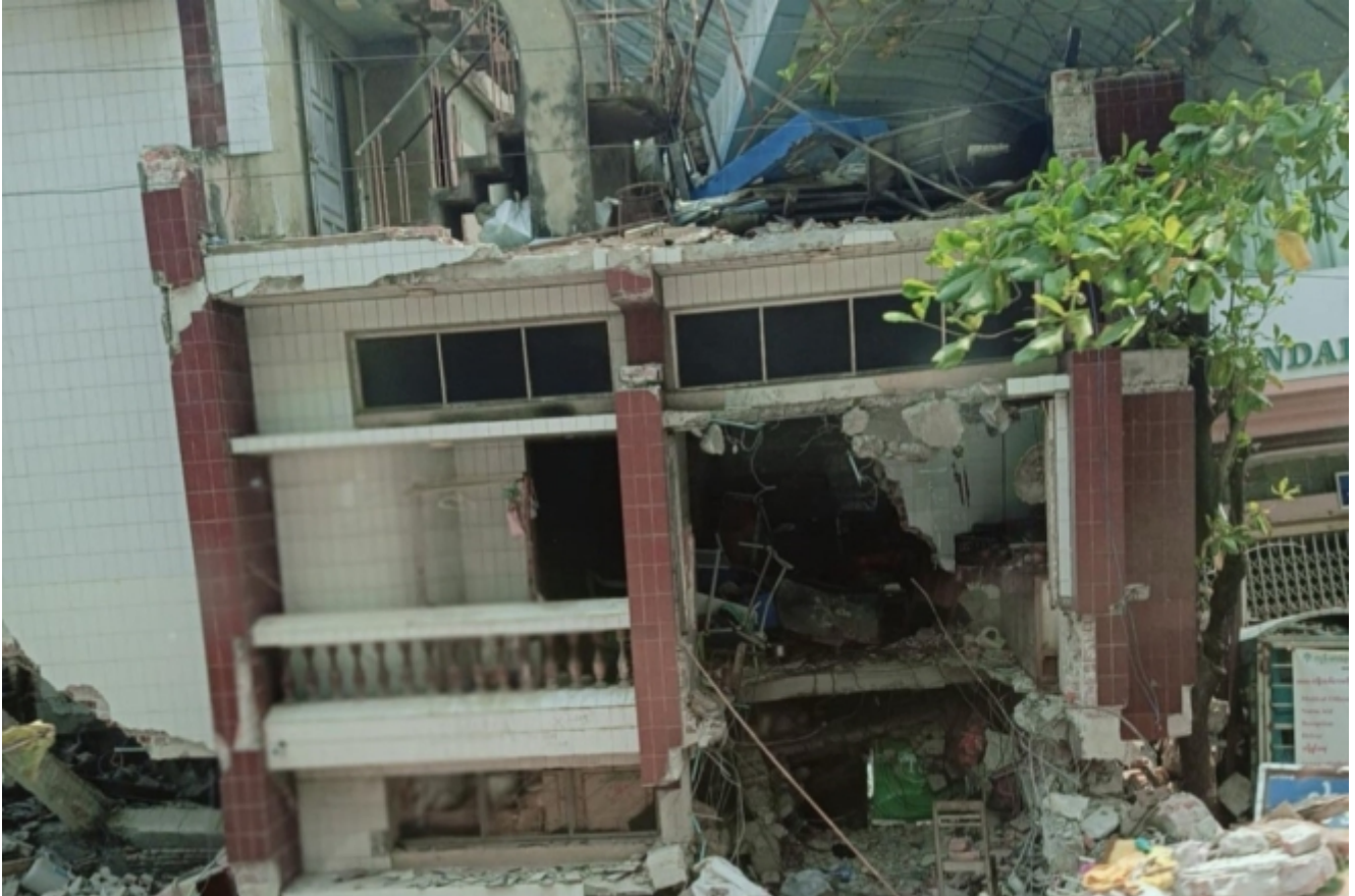
Zerstörtes Haus nach dem Erdbeben
